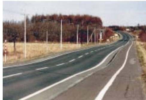
写真11.1 長期にわたり沈下が発生し、路面が波打つ泥炭地盤上の道路
