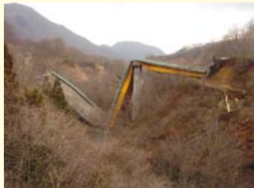
倒壊した祭時（まつるべ）大橋
