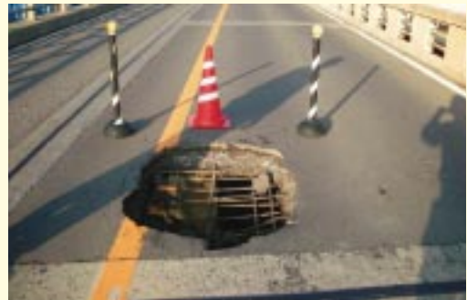
供用中における重大損傷事例
