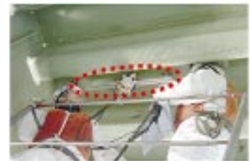
鋼床版デッキプレート進展き裂の超音波探傷法の現場での適用状況
