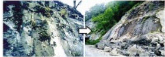
(平成8年度点検時) (地震後) 亀裂が多数発達していた吹付のり面の崩壊事例
