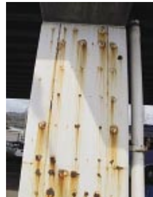
耐震補強としてRC橋脚に巻き立てられた鋼板とその腐食状況
