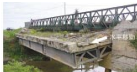
スマトラ島沖大地震による津波の被災例
