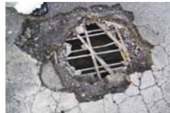
陥没が生じたRC床版
