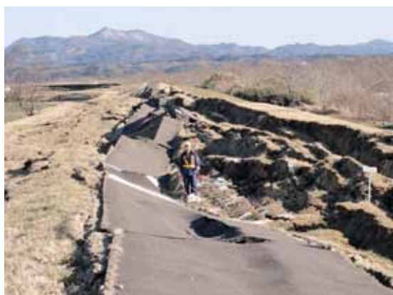
液状化により被災した堤防の調査
