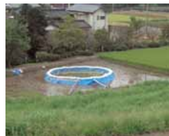
図2.4 基礎地盤漏水
