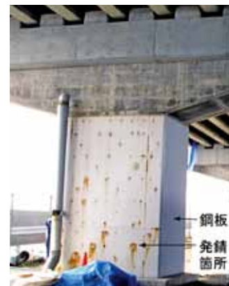
耐震補強としてRC橋脚に巻き立てられた鋼板とその腐食状況劣試験
