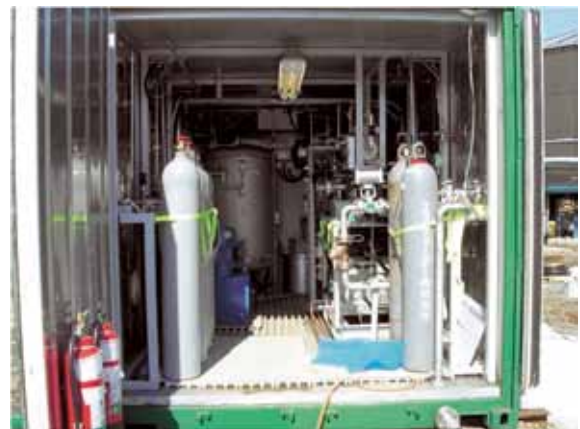
写真－1 バイオガス精製圧縮装置
