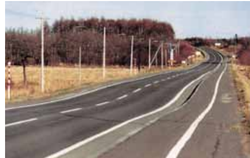
写真11.1 長期にわたり沈下が発生し、路面が波打つ泥炭地盤上の道路
