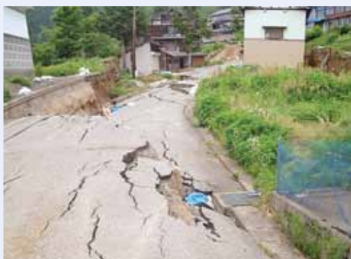
【集落内の被災状況】 （撮影：平成21年6月13日）
