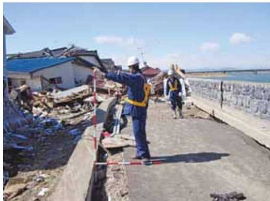
特殊堤の被災状況の調査
