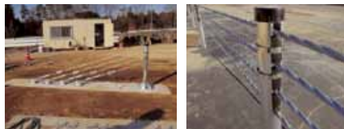
写真7.9 ワイヤーロープ式防護柵
