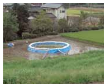
図2.4 基礎地盤漏水
