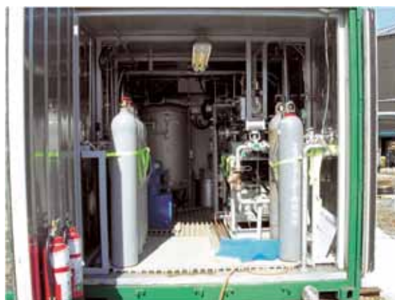
写真－1 バイオガス精製圧縮装置
