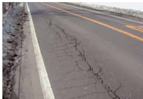
写真11.4 融解期の路床の支持力低下によるクラック
