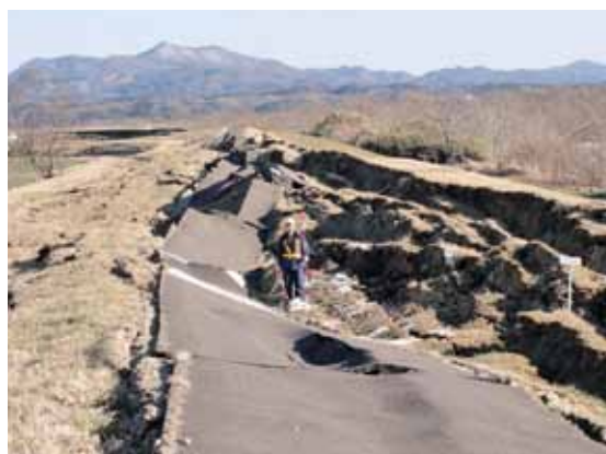
液状化により被災した堤防の調査
