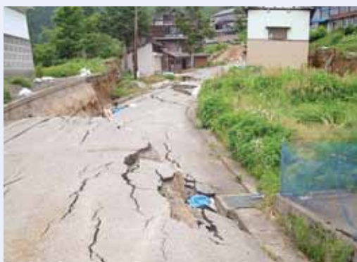
【集落内の被災状況】 （撮影：平成21年6月13日）
