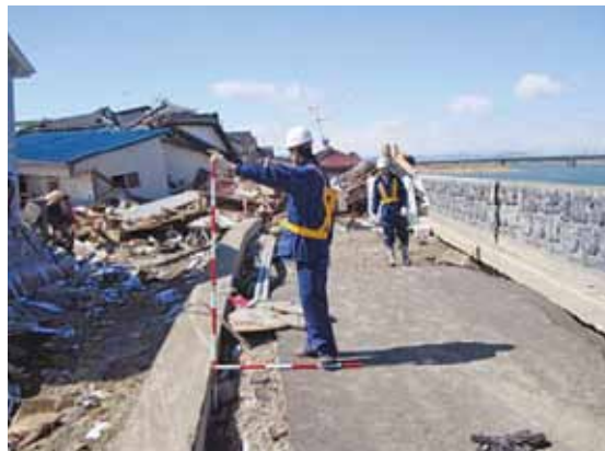
特殊堤の被災状況の調査
