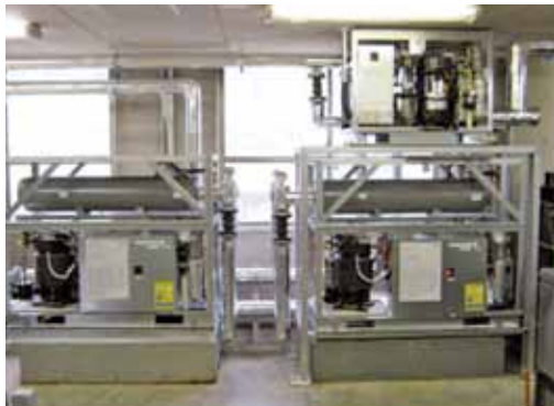
写真-7.1.1 凍結融解試験設備 (試験槽熱交換ユニット更新)
