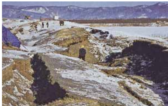
泥炭性軟弱地盤における盛土の大規模地震による被害
