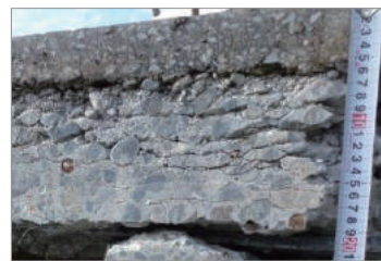
RC床版の層状 ひび割れ状況
