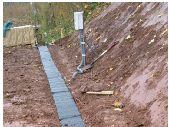
立体網状スパイラル構造を有する小段排水溝
