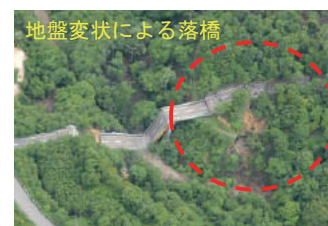
(a) 祭時大橋の落橋(2008年岩手・宮城内陸地震)
