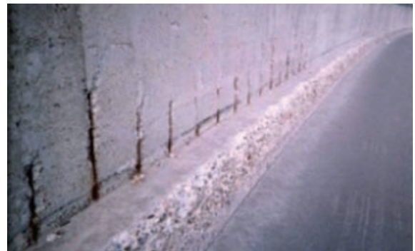
図-14.2 凍害・塩害によるRC壁高欄の複合劣化
