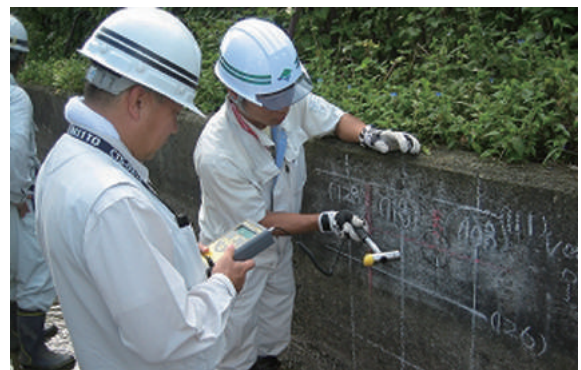
図-14.4 開水路の内部劣化の検出
