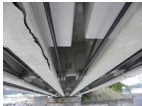
塩害橋の再劣化状況
