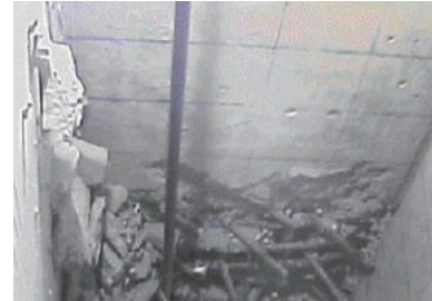
(b) 内面の損傷
