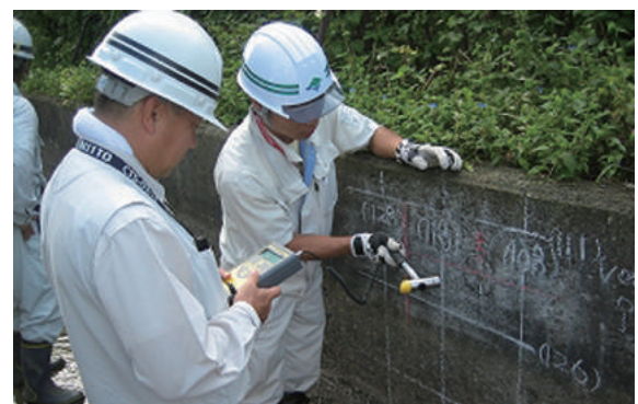
図-14.4 開水路の内部劣化の検出
