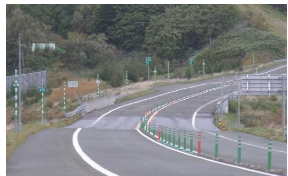
図-14.3 泥炭地盤上の道路の不同沈下
