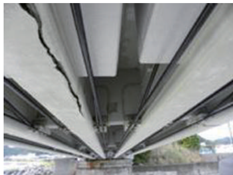
塩害橋の再劣化状況
