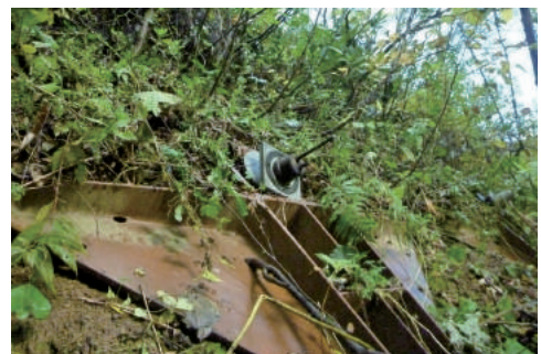
アンカー頭部の破損発生状況
