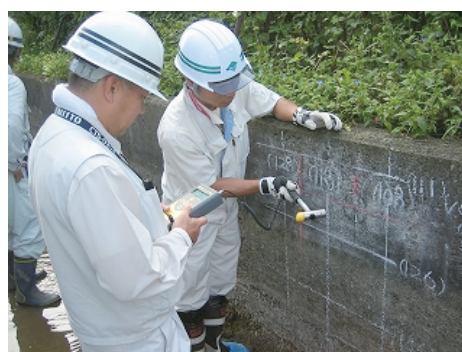
図-14.4 開水路の内部劣化の検出
