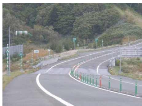
図-14.3 泥炭地盤上の道路の不同沈下
