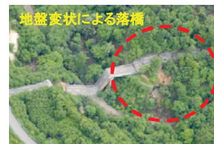
(a) 祭時大橋の落橋(2008年岩手・宮城内陸地震)
