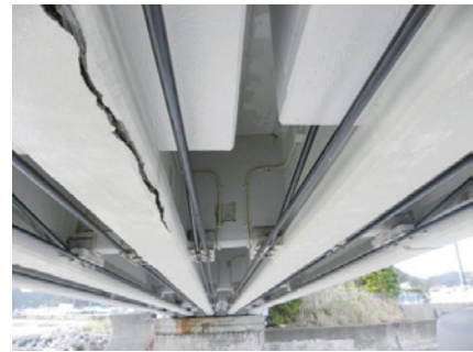
塩害橋の再劣化状況
