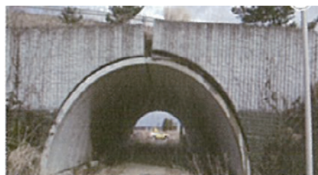
プレキャストアーチカルバートの損傷事例
