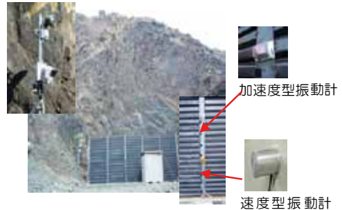
崩落検知システムの配置状況
