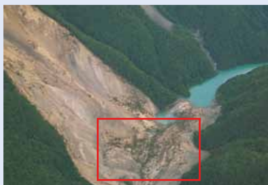
写真-1 上空から被災状況の確認 ※赤枠内のような人が入れない危険箇所を無人化施工を適用
