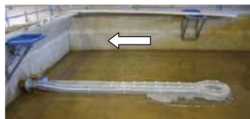
管径200mmの排砂管の設置状況
