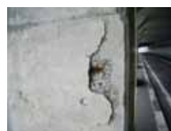
覆工柱部の損傷例
