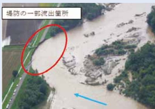
写真-1 堤防流出箇所
