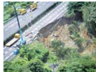
(b) 東名高速牧之原の盛土崩壊(2009年駿河湾を震源とする地震)
