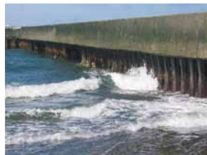
図14.4 海水作用による沿岸構造物の損傷
