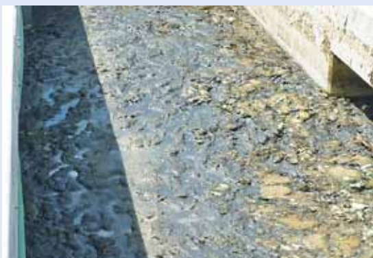
写真-1 沈殿池の汚泥の堆積状況
