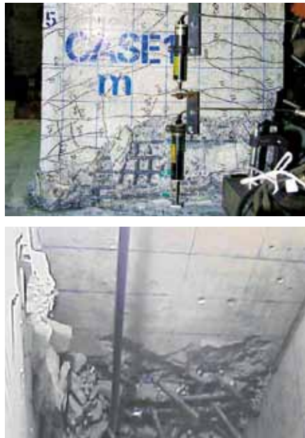
図3.6 中空断面RC橋脚の損傷状況 (上:外面の損傷,下:内面の損傷)
