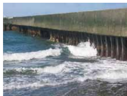
図14.4 海水作用による沿岸構造物の損傷
