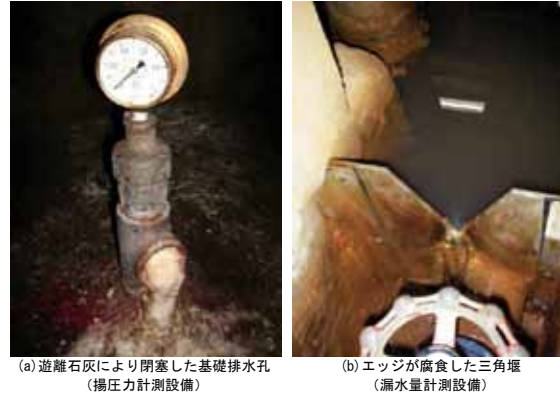
写真-1 故障や老朽化した計測機器の例
