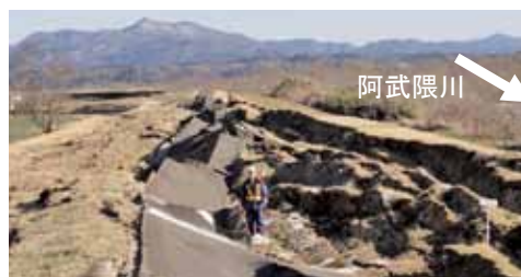
図1.3 堤体液状化による被災事例
