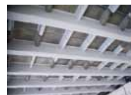
頂版の補修例
