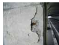
覆工柱部の損傷例
