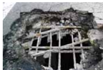
RC床版の上面脆弱化後の陥没例
