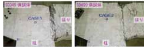
実験終了後の接合部のひび割れ状況
