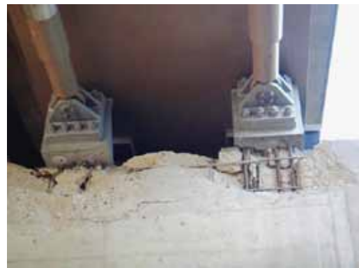
東日本大震災における制震デバイス取付部の被災
