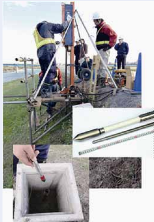
写真-1 打ち込み式水位観測装置 特許第5044852 共有権利者：応用地質(株)
