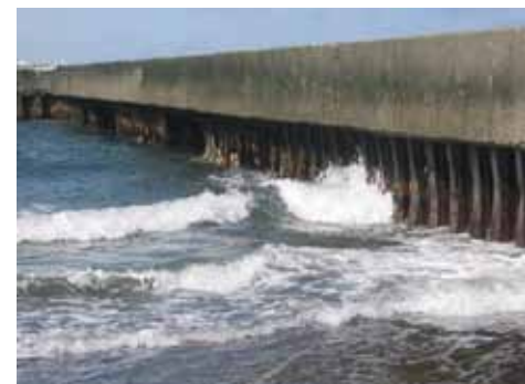
図 14.4 海水作用による沿岸構造物の損傷
