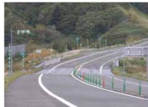
図 14.3 泥炭地盤上の道路の不同沈下
