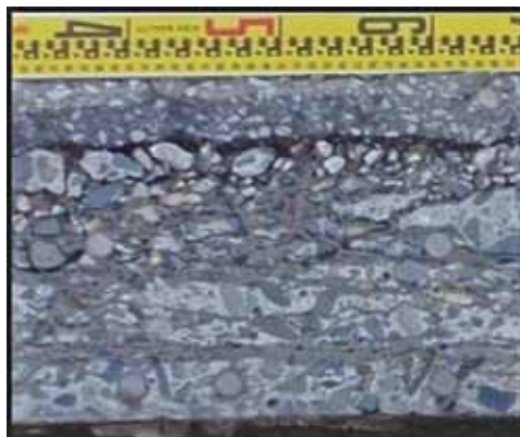
床版切断面の損傷劣化
