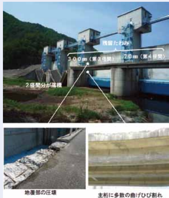
写真－1 普代水門管理橋の被災状況
