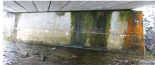
写真-1 試験施工橋梁の漏水状況 (右岸橋台前面)
