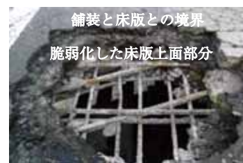
RC 床版の上面脆弱化後の陥没例
