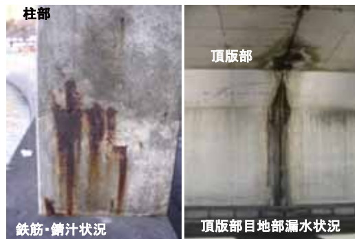
既設落石覆工の損傷事例
