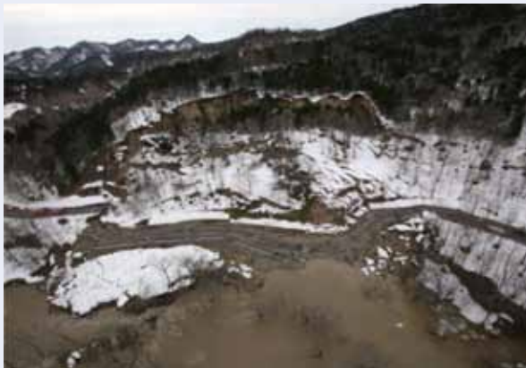
写真-1 地すべりに伴う道路崩壊箇所(国道 239 号)
