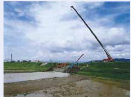
写真-1 矢部川の破堤箇所
