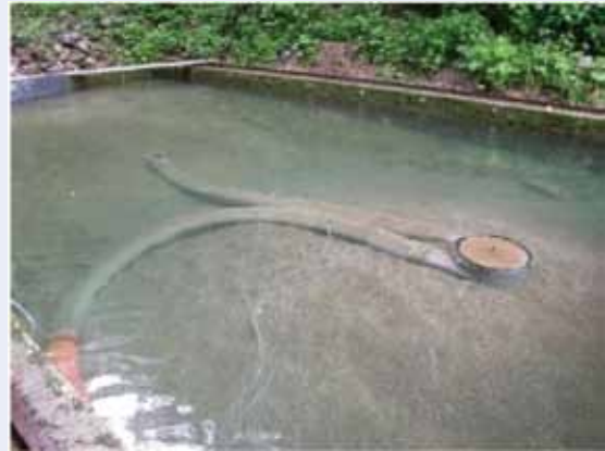
写真-1 潜行吸引式排砂管
