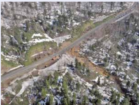
写真-3 土砂崩れに伴う道路崩壊箇所(国道 230 号)
