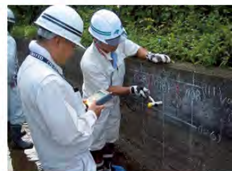
図-14.4 開水路の内部劣化の検出
