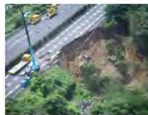
(b) 東名高速牧之原の盛土崩壊（2009年駿河湾を震源とする地震）
