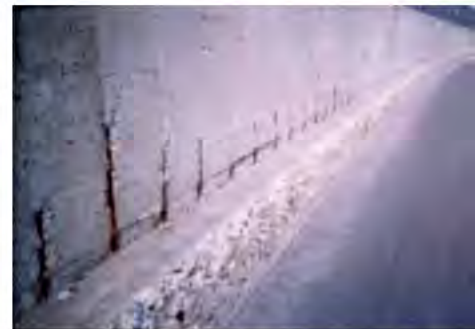
図-14.2 凍害・塩害によるRC壁高欄の複合劣化
