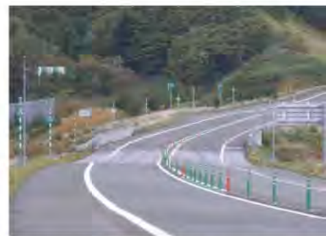
図-14.3 泥炭地盤上の道路の不同沈下
