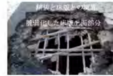
RC 床版の上面脆弱化後の陥没例
