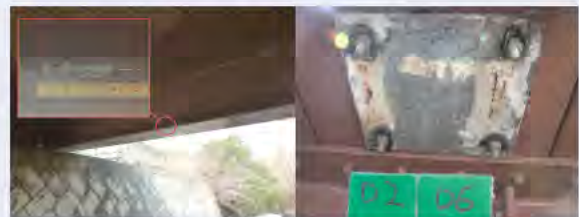
写真-1 橋梁の実態調査（左：外的要因による損傷、右：高欄取付部下面のベースプレートの腐食）
