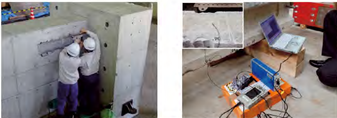
写真-1.5.4 撤去部材などを用いた非破壊検査技術の試行 (左：鉄筋破断探査 右：振動計測状況)
