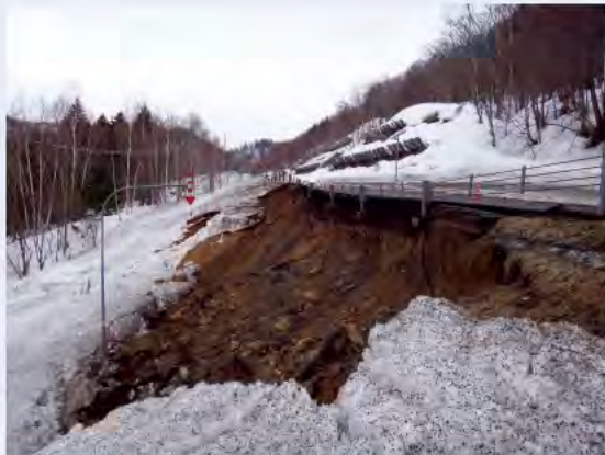
写真-1 国道 230 号の盛土法面の崩壊
