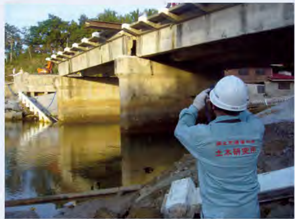
写真-1 落橋した橋の調査
