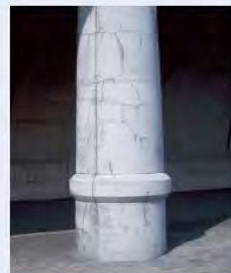
写真-3 支柱部の劣化
