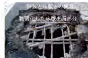
RC 床版の上面脆弱化後の陥没例
