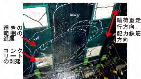
補強前後の床版下面におけるコンクリートの主鉄筋方向ひび割れのひび割れ幅の変化(上)と輪荷重走行試験における床版下面の疲労損傷(下)
