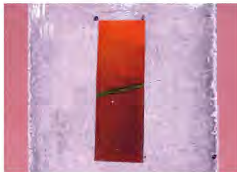
モルタルのひび割れを可視化した例
