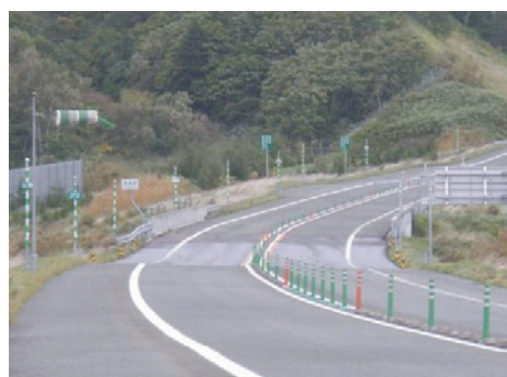
図-14.3 泥炭地盤上の道路の不同沈下
