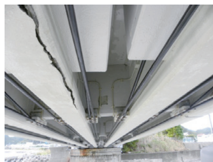
塩害橋の再劣化状況
