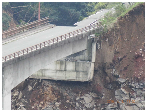
図-1 平成28年熊本地震における地盤災害
