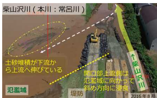
写真-1 平成28年の北海道豪雨の際にバックウォーター現象により堤防決壊した常呂川水系柴山沢川(写真提供:北海道開発局)
