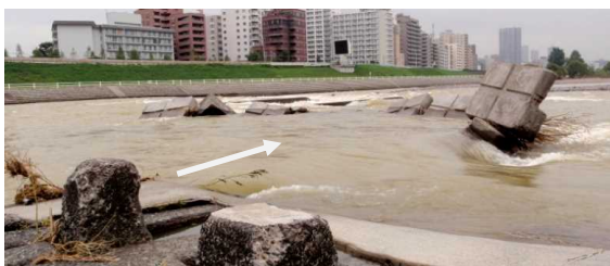
写真-2 床止の護床ブロックがめくれている様子 （平成23年9月の出水後の豊平川）
