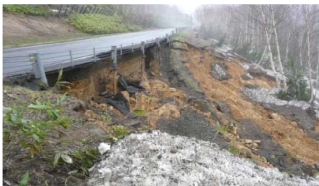
図-1 融雪期に発生した道路盛土変状事例
