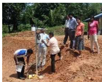
図-2 地上雨量計の設置
