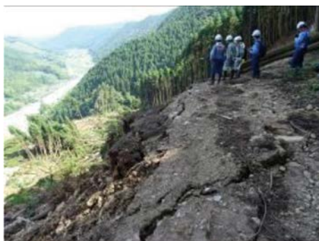
写真-1.1.3.1 地すべり崩壊の全景
