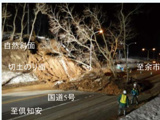
写真-1 斜面災害の様子
