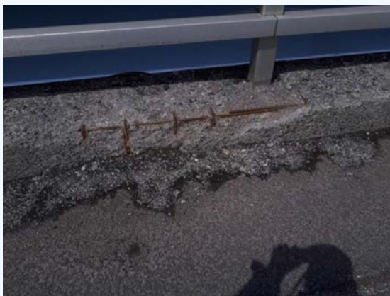
写真-1 スケーリング
