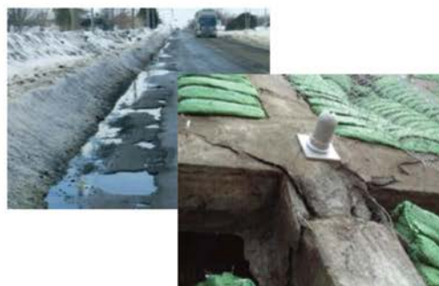
写真-2 凍上や融雪水による損傷（道路舗装・コンクリート法枠）
