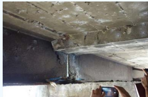
写真-2 塩害により腐食損傷した鋼桁の様子
