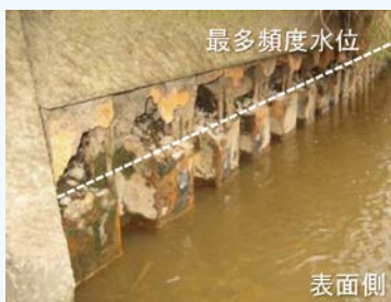
写真-1 鋼矢板の腐食事例 (北海道内の排水路)
