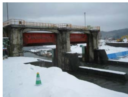
図-3 凍害と摩耗を受ける頭首工の堰柱と摩耗と腐食を受けるゲート
