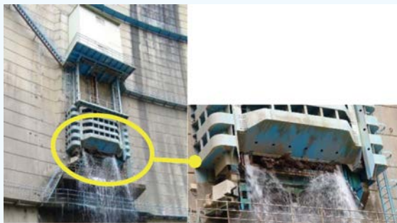
写真-1 不具合が生じたゲートの状況
