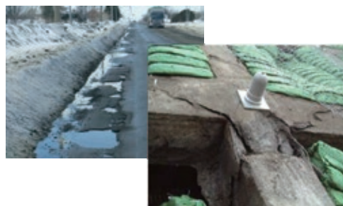
写真-2 凍上や融雪水による損傷（道路舗装・コンクリート法枠）
