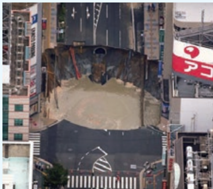
写真-1 福岡市地下鉄の道路陥没事故
