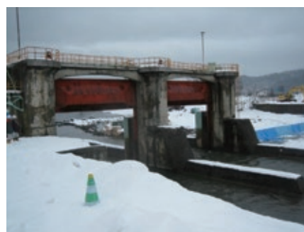
図-3 凍害と摩耗を受ける頭首工の堰柱と摩耗と腐食を受けるゲート
