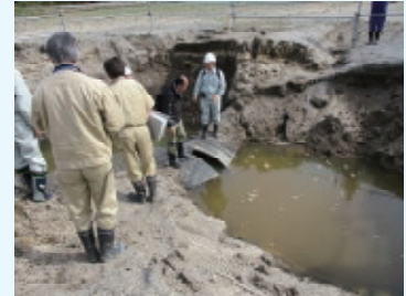
写真-1 用水管の離脱状況
