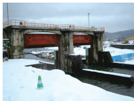
図-3 凍害と摩耗を受ける頭首工の堰柱と摩耗と腐食を受けるゲート
