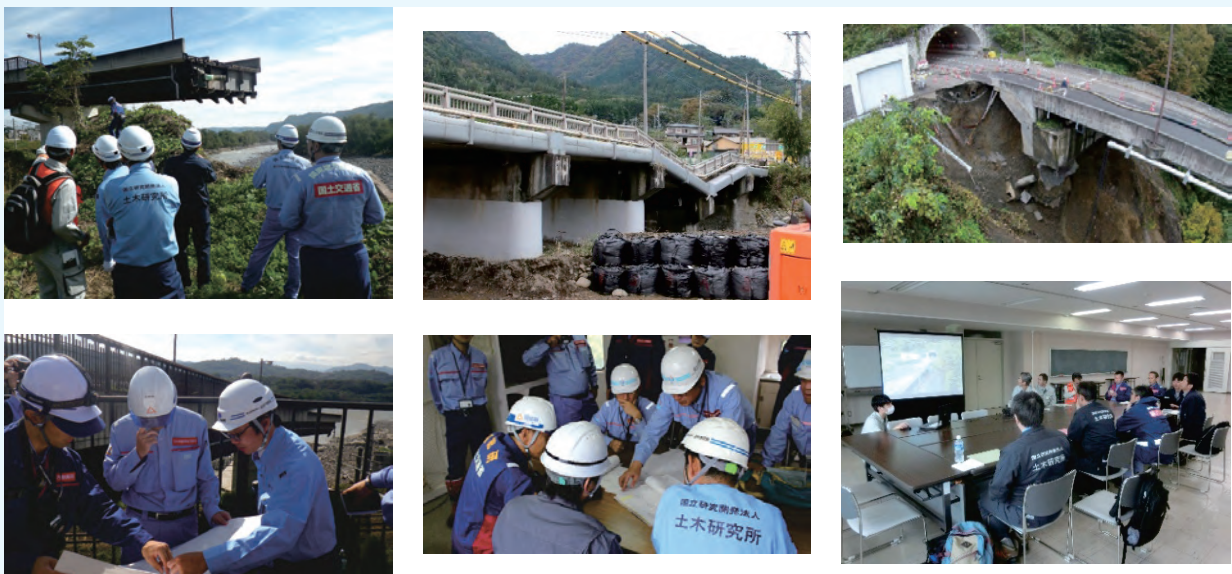
写真-1 被災橋梁の状況及び派遣職員と道路管理者との打合せ (左2枚：市道海野宿橋、中央2枚：国道20号法雲寺橋、右2枚：国道361号権兵衛2号橋)
