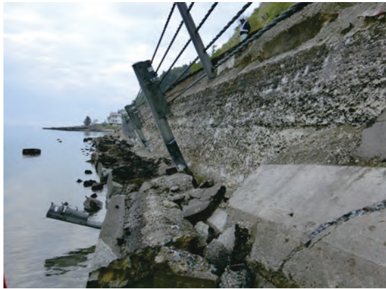
写真-1.2.3.3 国道228号の海岸擁壁倒壊
