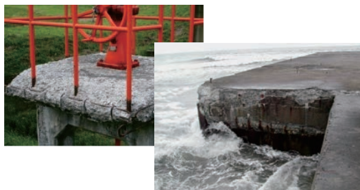
写真-1 凍害や塩害・摩耗との複合劣化（樋門・沿岸構造物）
