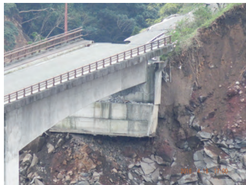
図-1 平成28年熊本地震における地盤災害
