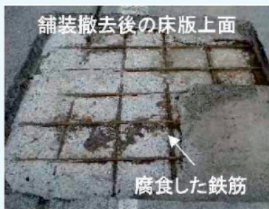
写真-1 橋梁の鉄筋コンクリート床版の塩害劣化事例（平成26年1月22日「高速道路資産の長期保全及び更新のあり方に関する技術検討委員会」報告書より）
