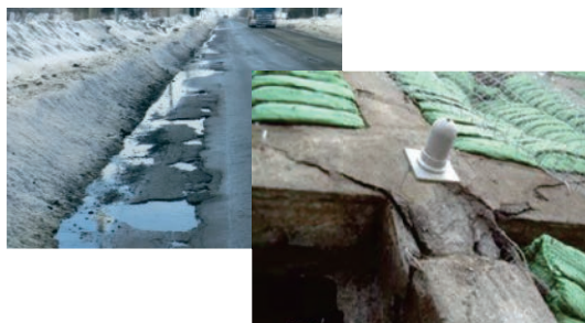
写真-2 凍上や融雪水による損傷（道路舗装・コンクリート法枠）
