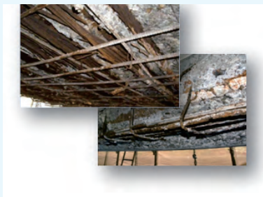
写真-1 塩分が浸透し劣化したコンクリート橋
