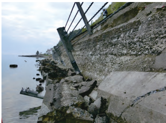
写真-1.2.3.3 国道228号の海岸擁壁倒壊
