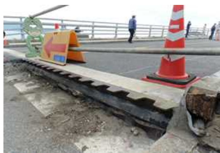
写真 - 1.2.3.1 主桁の跳ね上がり
