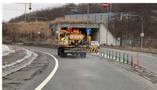
図-7 実道における散布支援システムの実践的検証（一般国道235号）
