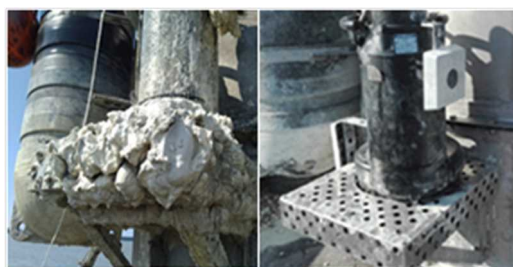
写真-1 吸水口の閉塞状況 (左: EL-9.0m で 1 年稼働後、右: 設置時)
