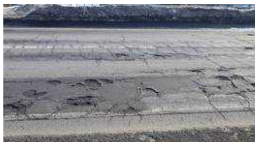
写真-1 ポットホールの発生状況
