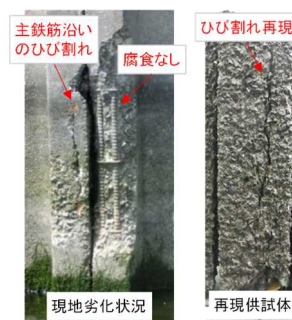
写真-3 矢板の劣化状況と再現供試体
