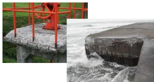
写真-1 凍害や塩害・摩耗との複合劣化（樋門・沿岸構造物）
