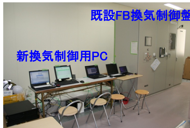
新換気制御の状況【電気室内】
