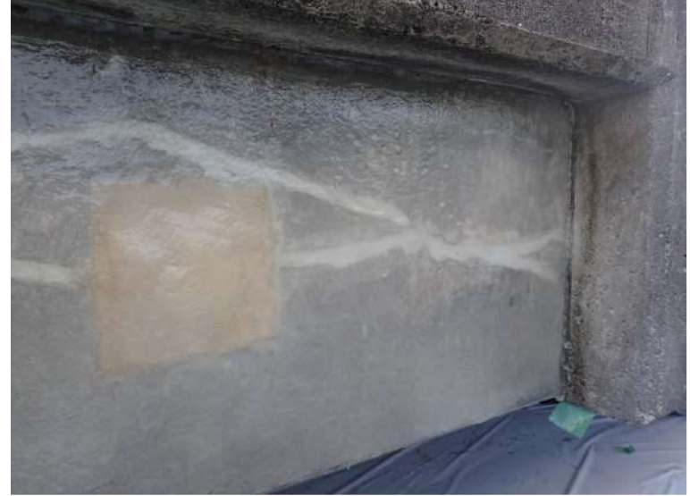
道路橋(補修箇所が多い)
