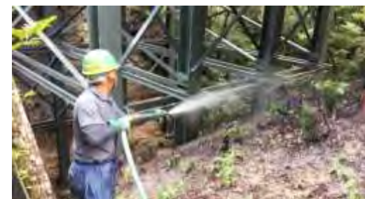
工事荒廃箇所への適用例
