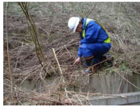
P3 下り線側 のり尻 湿潤状況
