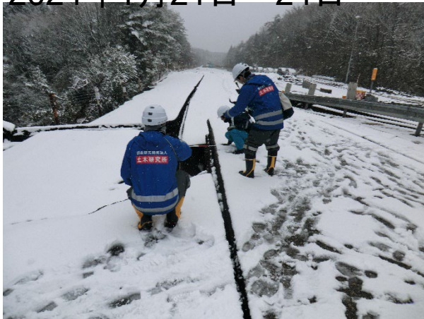
七尾市中島町別所における盛土変状調査状況
