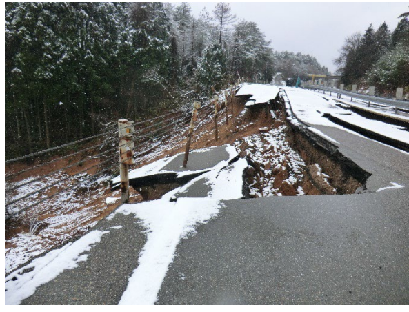
七尾市中島町別所における盛土変状
