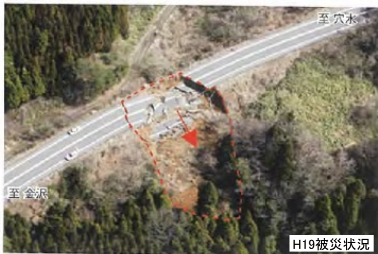
上下線の崩落 (H19.3月)
