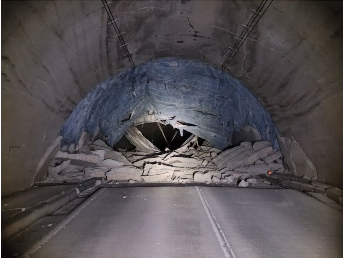
覆工の崩落状況 写真：国土交通省
