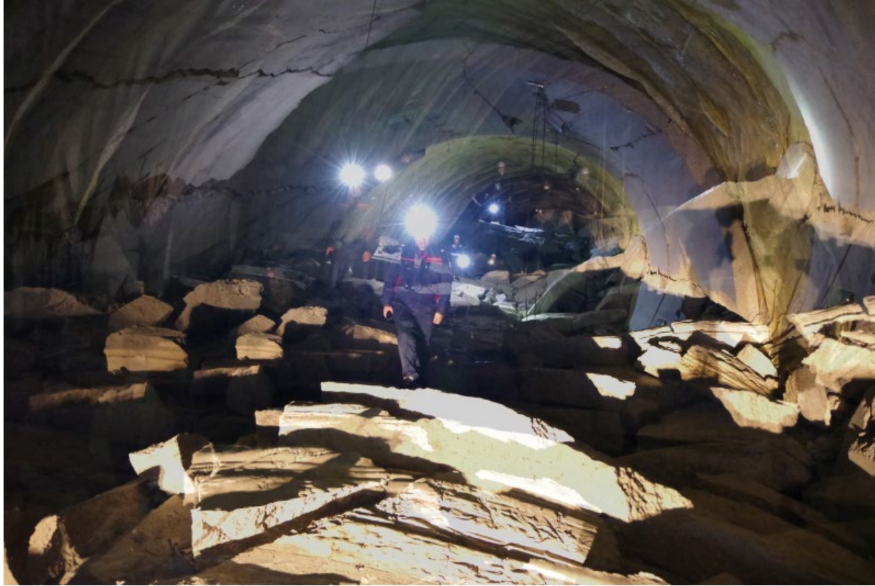
大谷Tnの様子（覆工崩落部）
