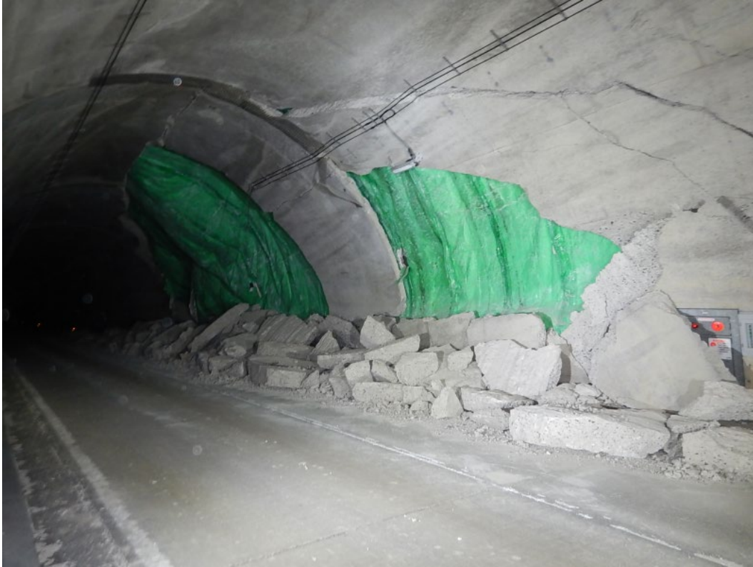
覆工の崩落状況
