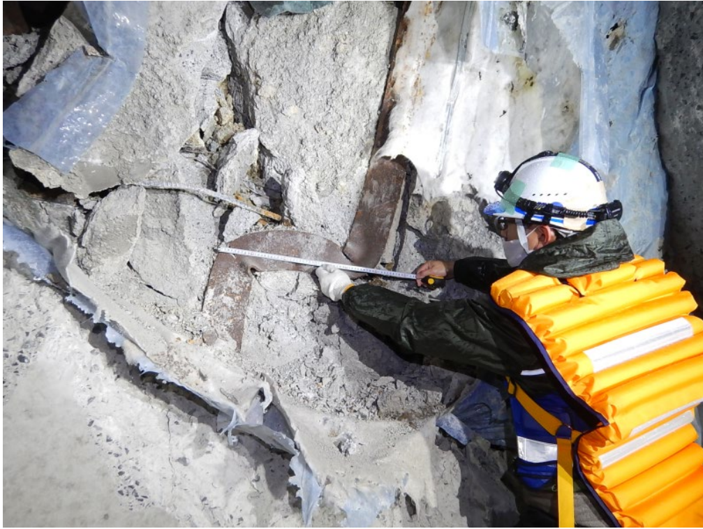
鋼アーチ支保工の約50cmの変形
