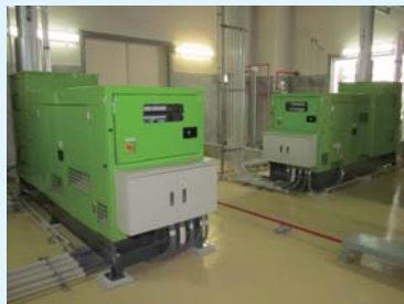
堀之内浄化センター(新潟県)での設置状況
