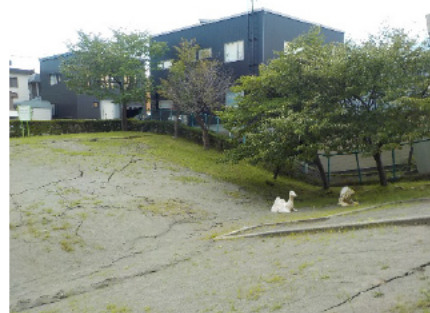
液状化した火山灰質土の抜け出しによる地盤の沈下
