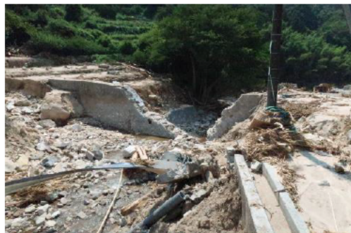
破壊された石積堰堤
