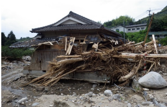
平成29年九州北部豪雨災害における流木被害
