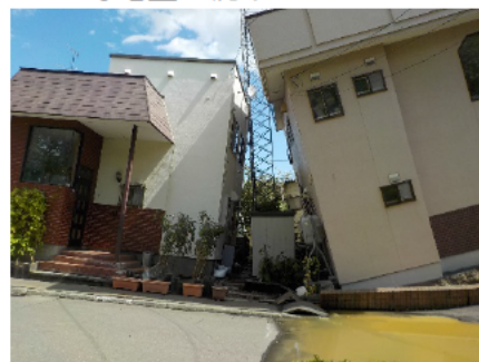
地盤沈下に伴う家屋の沈下・傾斜
