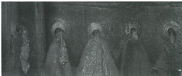
写真-1 閉塞した地下水排除工（集水井工昭和58年施工） 付着物は粘質物で、スライムという。
