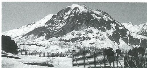
写真-1 新潟県能生町柵口地区に施工された雪崩防護施設
