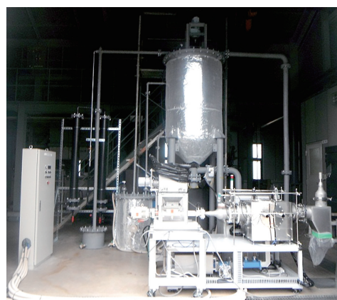
図－4.1.5 処理場に設置した実験機
