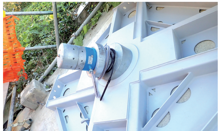
図－ 2.3.4 既設アンカー緊張力モニタリング（Aki-Mos）
