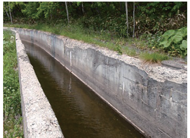
写真－ 4.4.2 農業用開水路の劣化状況
