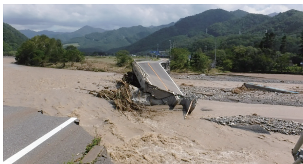
写真－ 5.1.4 国道橋の被災事例
