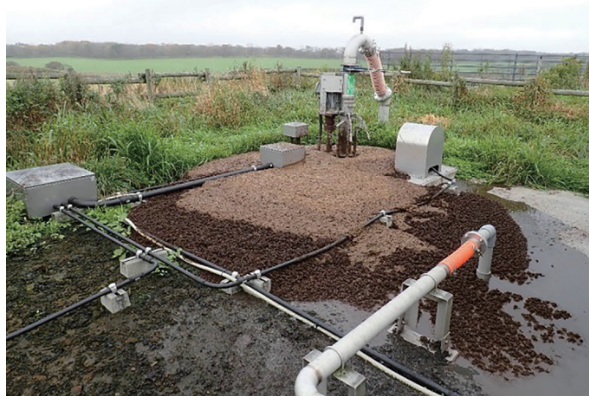
写真－4.4.1 調整槽からの泡溢流
