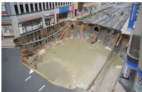
写真－ 5.1.7 道路陥没状況 (福岡市交通局ホームページより引用)
