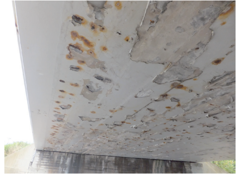
(a) 塩害による再劣化
