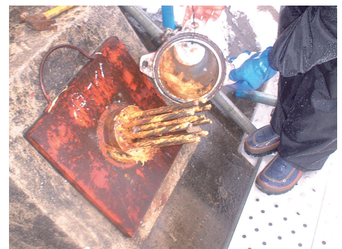
写真－9.1.2 点検の例（変色した防錆油）
