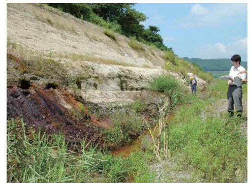
写真－9.1.1 酸性水が発生するのり面
