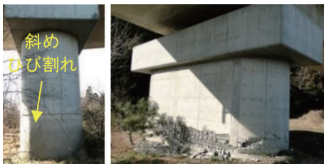
(b) 耐震補強が実施されていなかった橋
