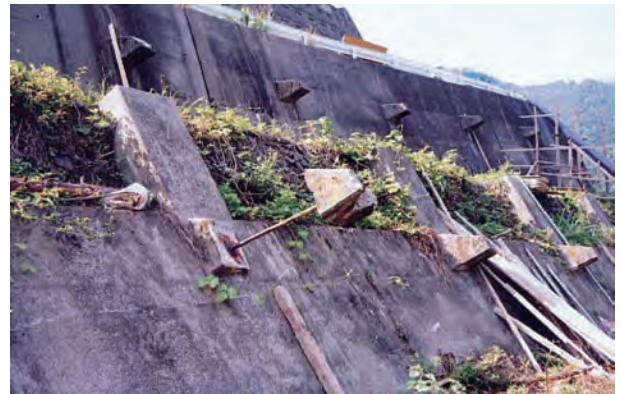
写真-2.1.3.8 アンカー頭部の飛び出し事例
