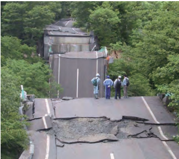
写真-2.4.2.3 岩手・宮城内陸地震における道路橋の被災調査
