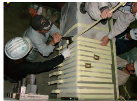
写真 - 2.4.3.4 地震による損傷を受けた橋脚の緊急機能回復技術の開発 (シートやバンドを活用)
