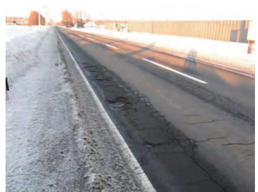
写真-2.2.3.14 疲労クラック箇所が発生した融雪期のポットホール
