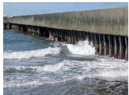
写真-2.2.4.14 鋼矢板式導流堤の著しい材料損耗の事例
