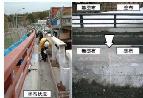
写真-2.2.3.6 スケーリング抑制対策
