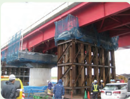
地震で被災した橋の復旧に関する技術相談への対応（現地調査）
