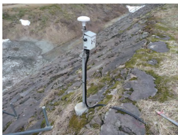
写真-2.1.5.5 石淵ダムに設置したGPSセンサー
