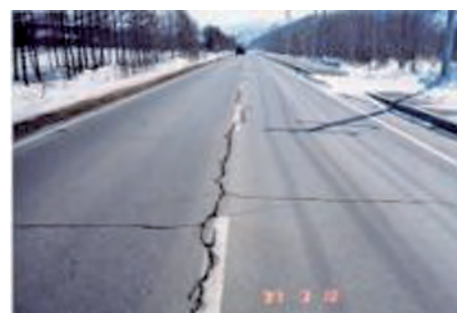
写真- 2.2.3.13 凍上クラック
