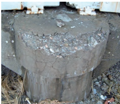
写真-2.2.3.9 ひび割れとスケーリング
