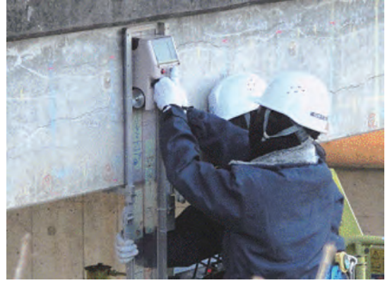
写真-2.4.4.3 既設PC橋のひび割れに関する現地調査(CAESARの現地調査と合わせて、非破壊検査技術や計測技術を有する交流会会員も、それぞれの技術について検証を行った。)
