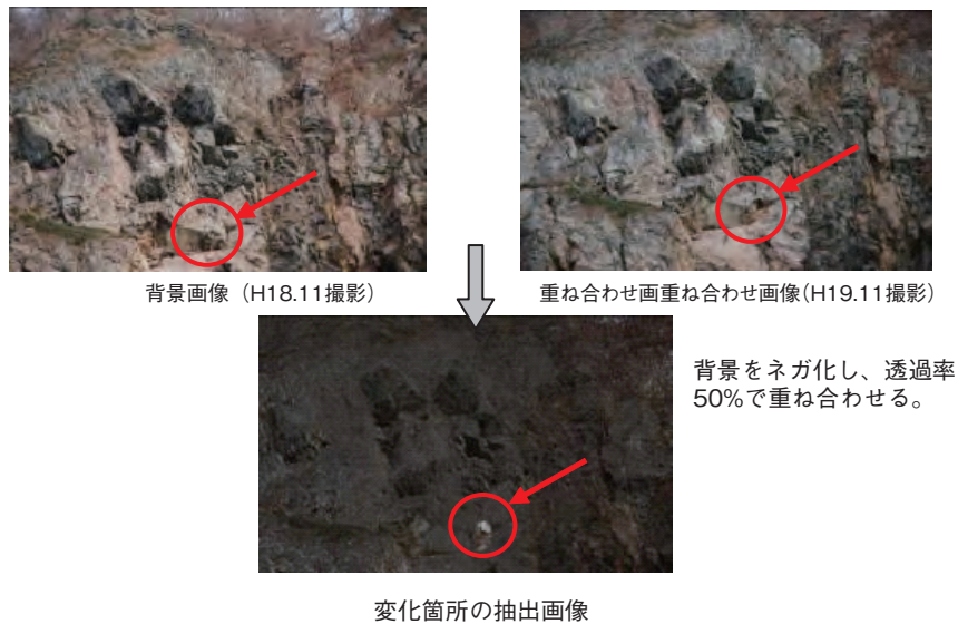
図- 2.2.2.17 背景差分法による変状箇所の抽出
