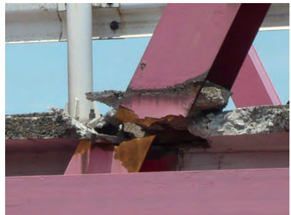
写真-2.4.1.1 木曾川大橋のトラス橋の斜材破断
