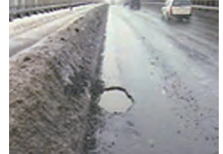
写真-2.2.3.4 ポットホール
