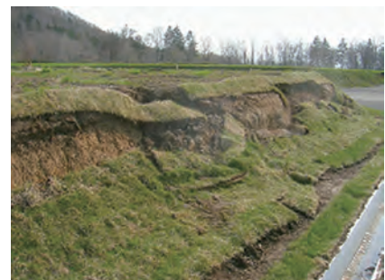
写真-2.2.2.17 春先の盛土の崩壊
