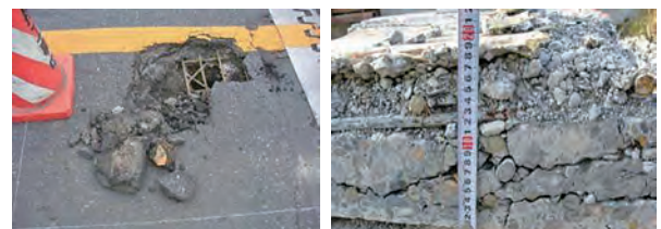
写真-2.2.2.10 RC床版の損傷状況
