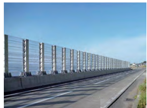
写真-2.2.4.17 現地に整備された越波防止フェンス
