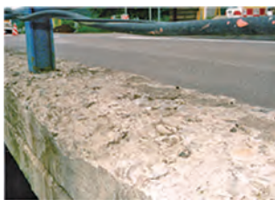
写真- 2.2.3.1 スケーリング
