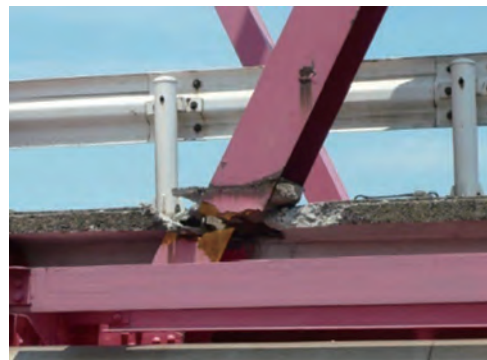
国道 23 号木曾川大橋斜材破断
