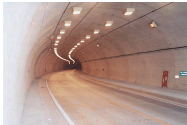
写真-1.3.3 カウンタービーム照明の適用例(新与那トンネル 国道58号)
