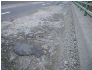
写真-2.2.2.1 凍害等によるRC床版の劣化・損傷
