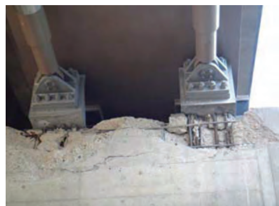
写真-2.4.5.9 東日本大震災における制震デバイス取付部の被災
