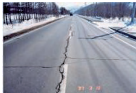
写真- 2.2.3.13 凍上クラック
