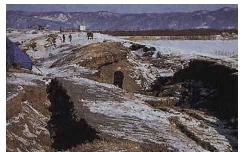
写真-2.2.2.16 泥炭地盤における河川堤防の地震被害事例
