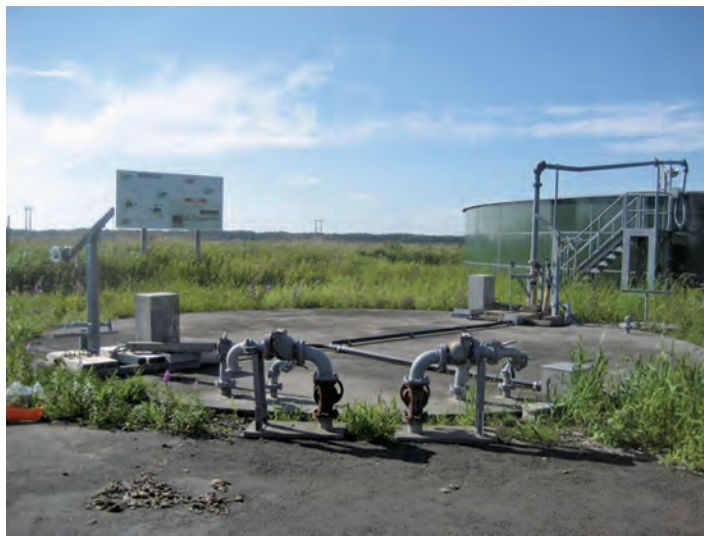
写真- 2.2.6.5 地下埋設型の曝気槽
