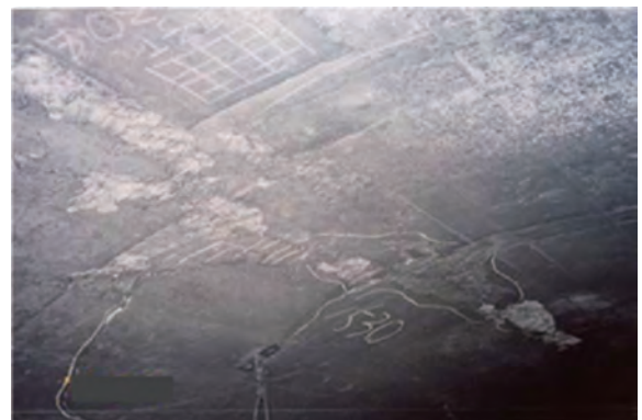
写真-3.2.4 覆工コンクリートの変状例
