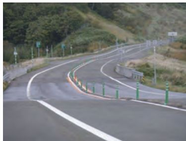
写真-2.2.2.2 泥炭性軟弱地盤上の道路の不同沈下
