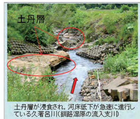
写真 - 2.2.4.5 土丹の侵食状況 (久著呂川)
