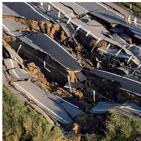
新潟県中越地震被害
