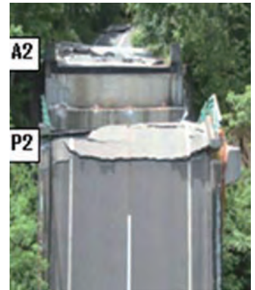
写真－ 2.4.5.2 祭時（まつるべ）大橋 (R342) の落橋 (平成 20 年岩手・宮城内陸地震)
