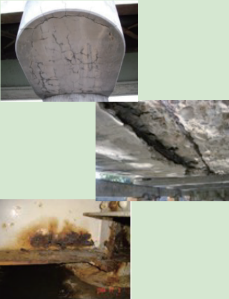
桁や下部構造などの劣化状態と各種要因との相関
