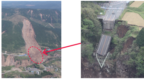
平成28年熊本地震の影響により復旧に長期間を要す被災が生じた橋
