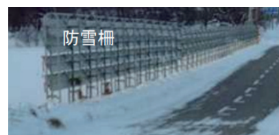
吹雪対策施設
