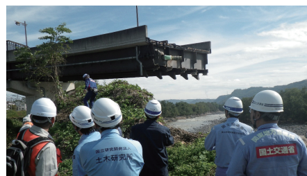
橋梁の被災状況調査(令和元年台風19号)
