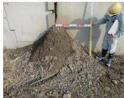
補強土背面土の流出例 (簡易な維持管理手法が必要)
