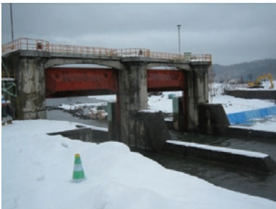
農業水利施設の劣化事例：凍害と 摩耗を受ける頭首工の堰柱と摩耗と 腐食を受けるゲート
