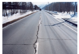
寒冷地特有の劣化損傷の対策
