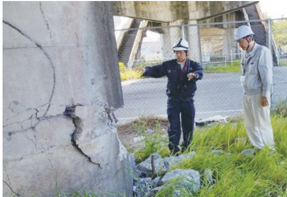
熊本地震：市道中央線 中央線陸橋現場における熊本市職員との被災調査状況（平成 28 年 4 月 17 日撮影）
