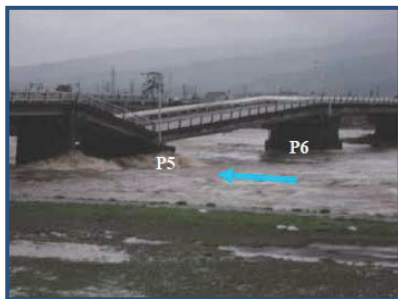
橋脚周辺の局所洗掘
