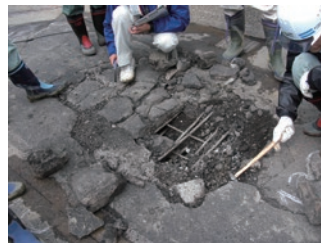
凍害等の影響による 道路橋床版の砂利化、陥没
