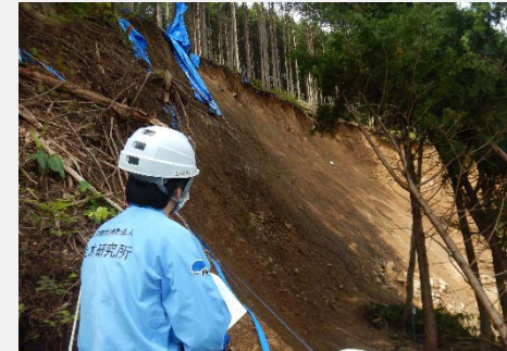
災害発生後に技術支援の要請を受け、災害現場にて調査を行います
