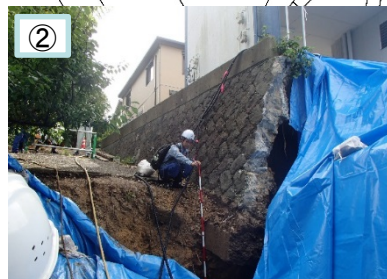
現地調査の様子② (宅地の変状状況)
